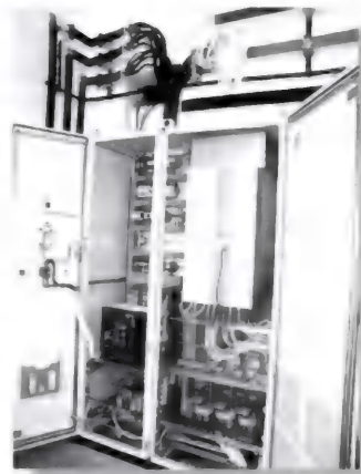
Система управления электроприводом
